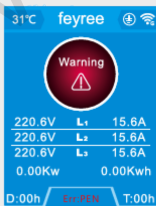
PE missing warns
